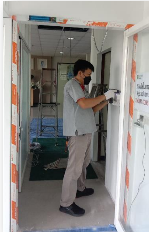
ติดตั้งชุด Access Control
