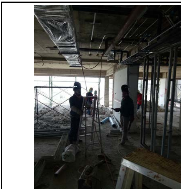
Activity ติดตั้งท่อ Main สปริงเกอร์ Floor 12 Date : 9 July 2563
