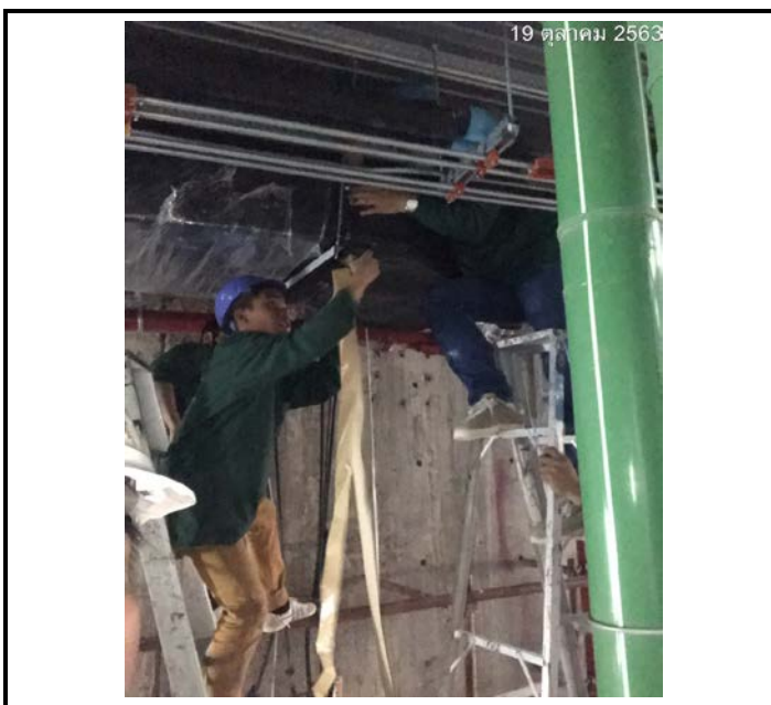
Activity เดินท่อตัดส้เข้าหน้าเครื่องปรับอากาศ บริเวณ Corridor Floor 08 Date : 19 October 2563
